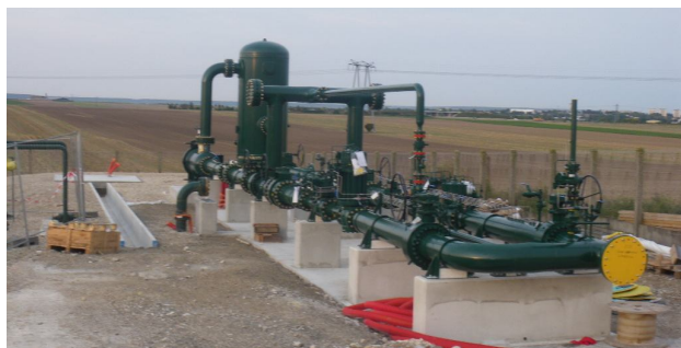
Poste de livraison de CERNAY LES REIMS
