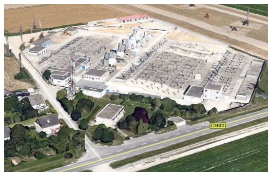
Le poste source « ORMES » (google EARTH)
